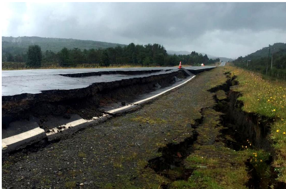
Grietas aparecen sobre y junto a una carretera cerca de Quellón, Chile, el domingo, 25 de diciembre de 2016, después de un terremoto.
